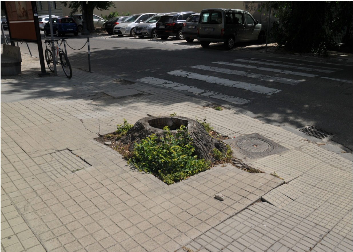
Foto n. 27 - Sollevamento pavimentazione dovuto alla presenza di apparato radicale superficiale delle alberature presenti e/o tagliate
