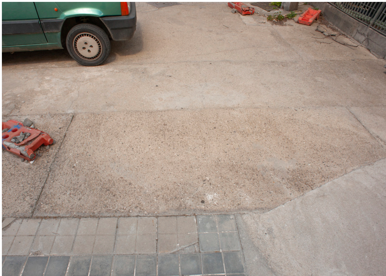
Foto n. 33 - Rappezzo incongruo con getto a base cementizia
