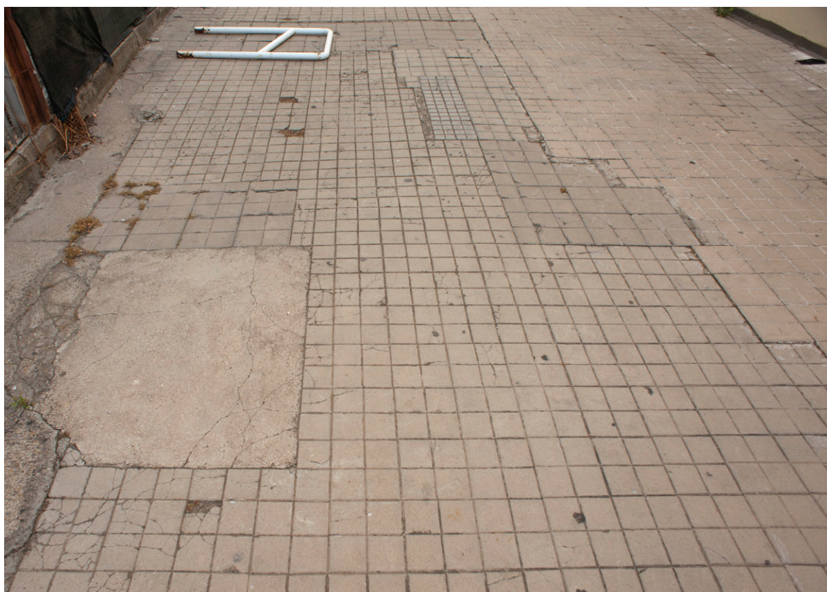
Foto n. 34 - Sostituzione pavimentazione con elementi incongrui
