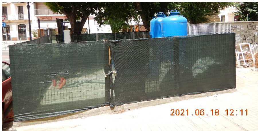
Figura 7 Impianto di bonifica P&T
