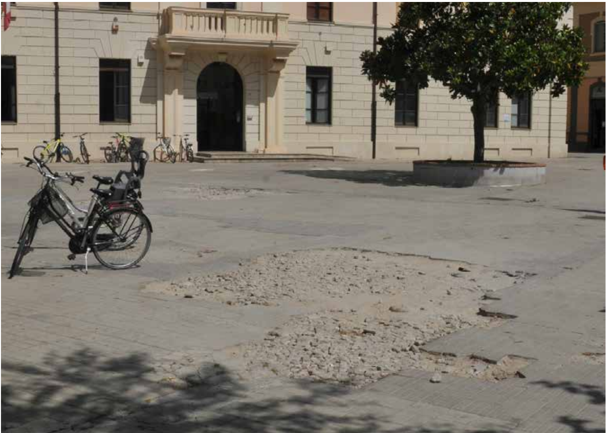
Foto n. 31 - Degrado pavimentazione con disgregazione e mancanza di elementi
