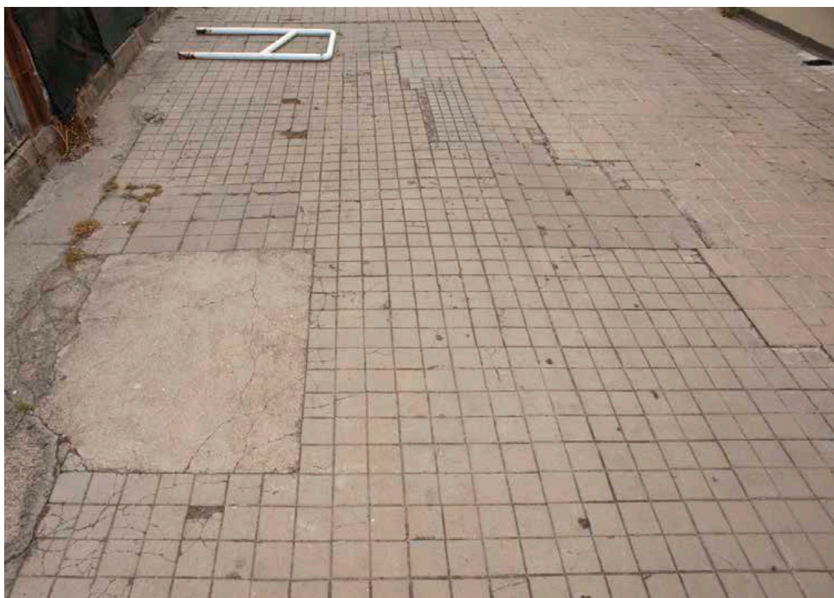
Foto n. 34 - Sostituzione pavimentazione con elementi incongrui
