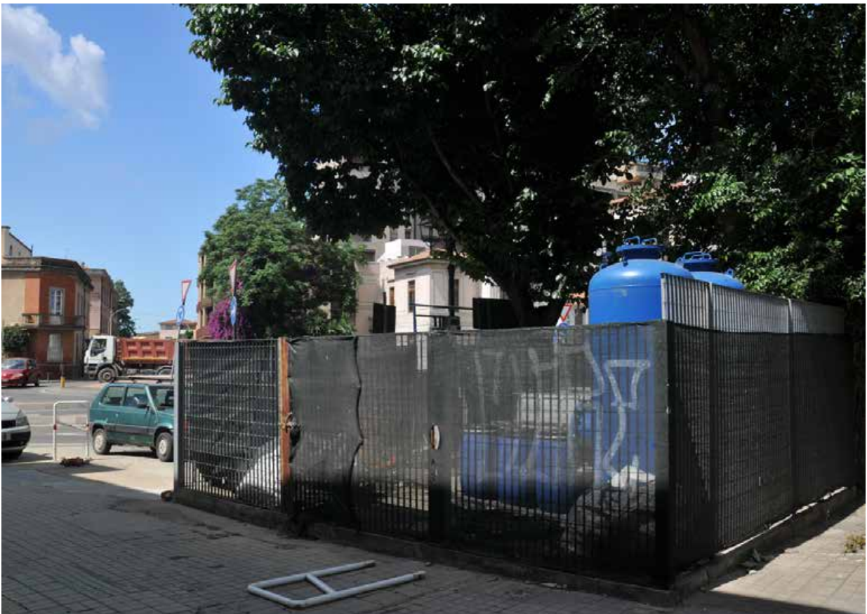
Foto n. 28 - Impianto di depurazione acque
