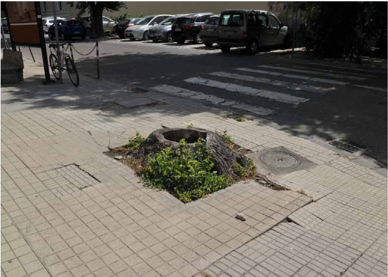
Foto n. 27 - Sollevamento pavimentazione dovuto alla presenza di apparato radicale superficiale delle alberature presenti e/o tagliate
