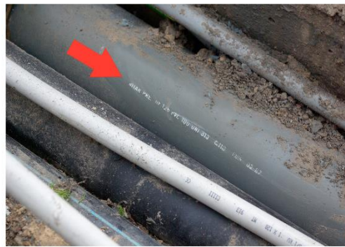
Foto 3 - La tubazione idrica antincendio nella canale posaimpanti
