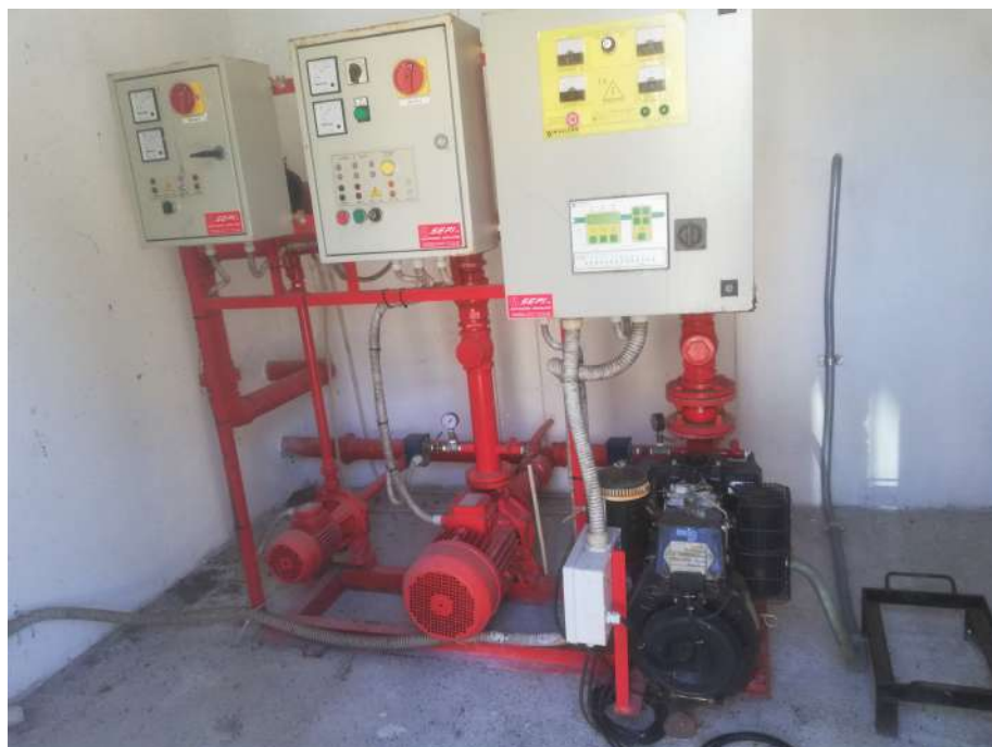
Figura 7 Impianto idrico antincendio
