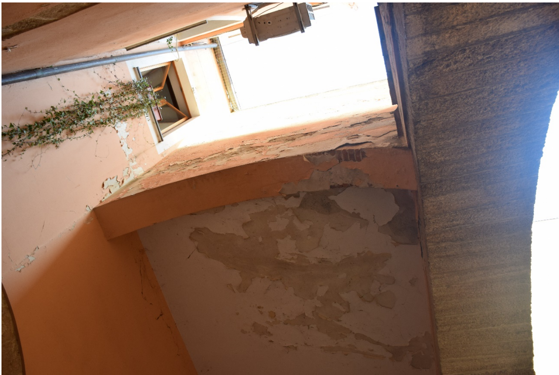
Particolare intonaci degradati
