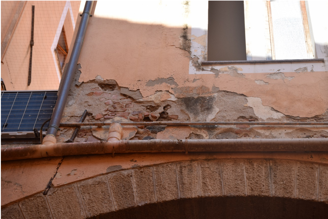
Particolare intonaci degradati
