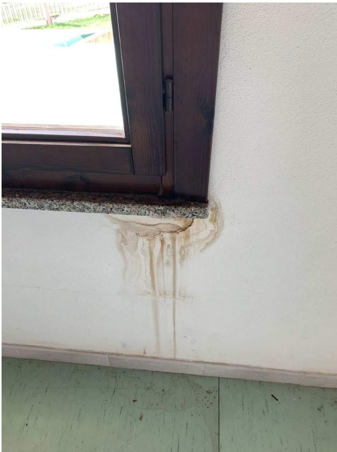
FOTO 21 - PIANO PRIMO – UMIDITÀ DI RISALITA NELLA FINESTRA DELLA SALA ATTIVITÀ
