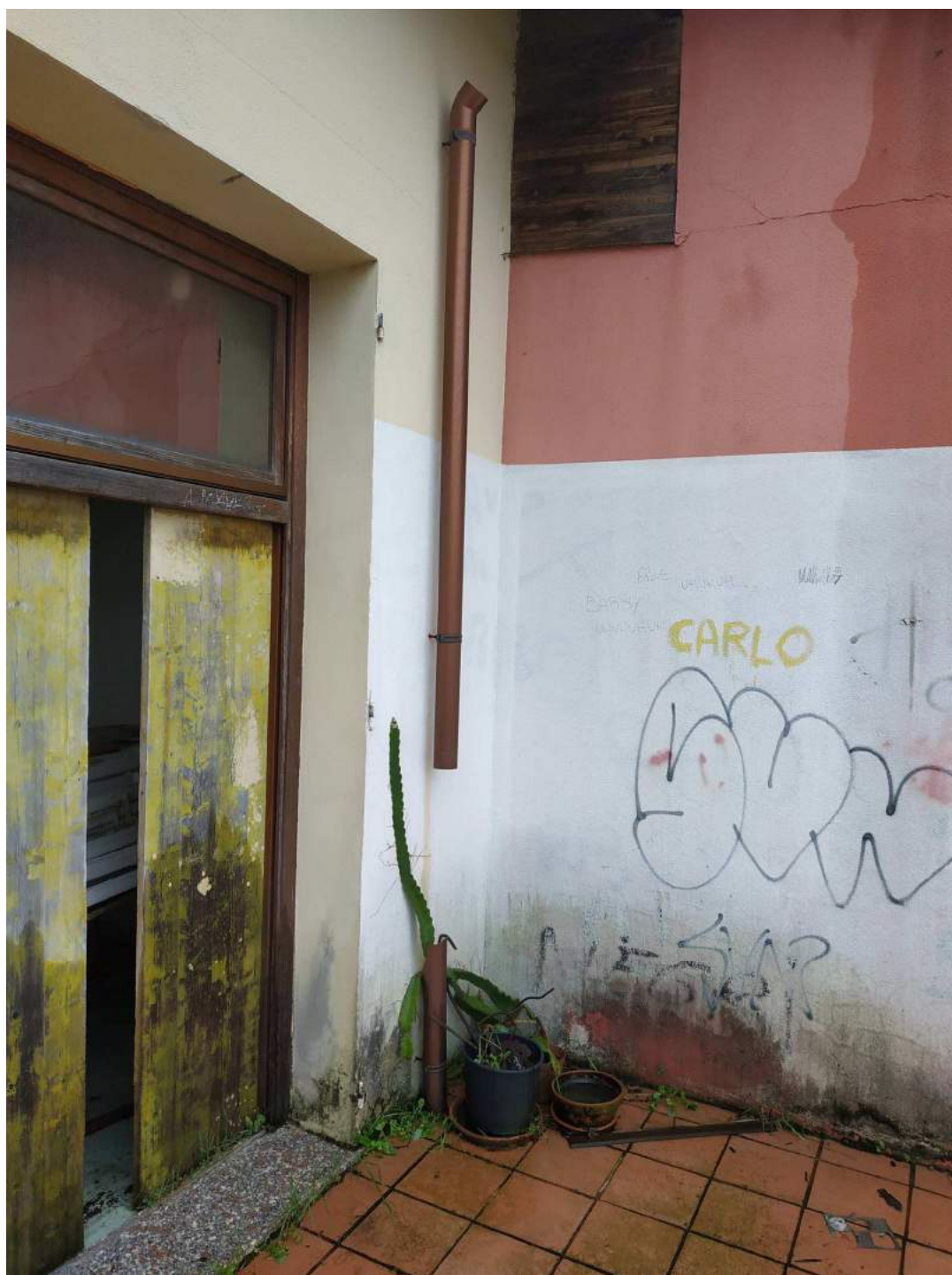
FOTO 6 - VISTA SITUAZIONE INFISSI ESTERNI
