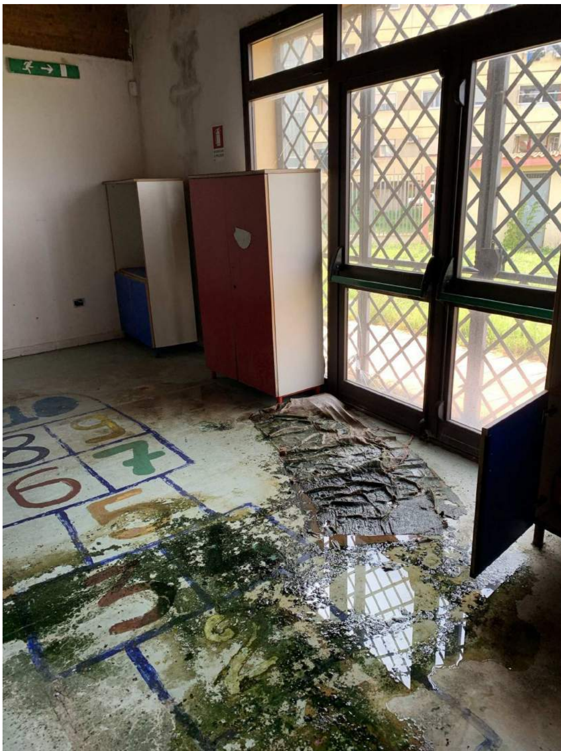
FOTO 19 - PIANO TERRA – PAVIMENTAZIONE ALL'INGRESSO DELLA SALA POLIFUNZIONALE
