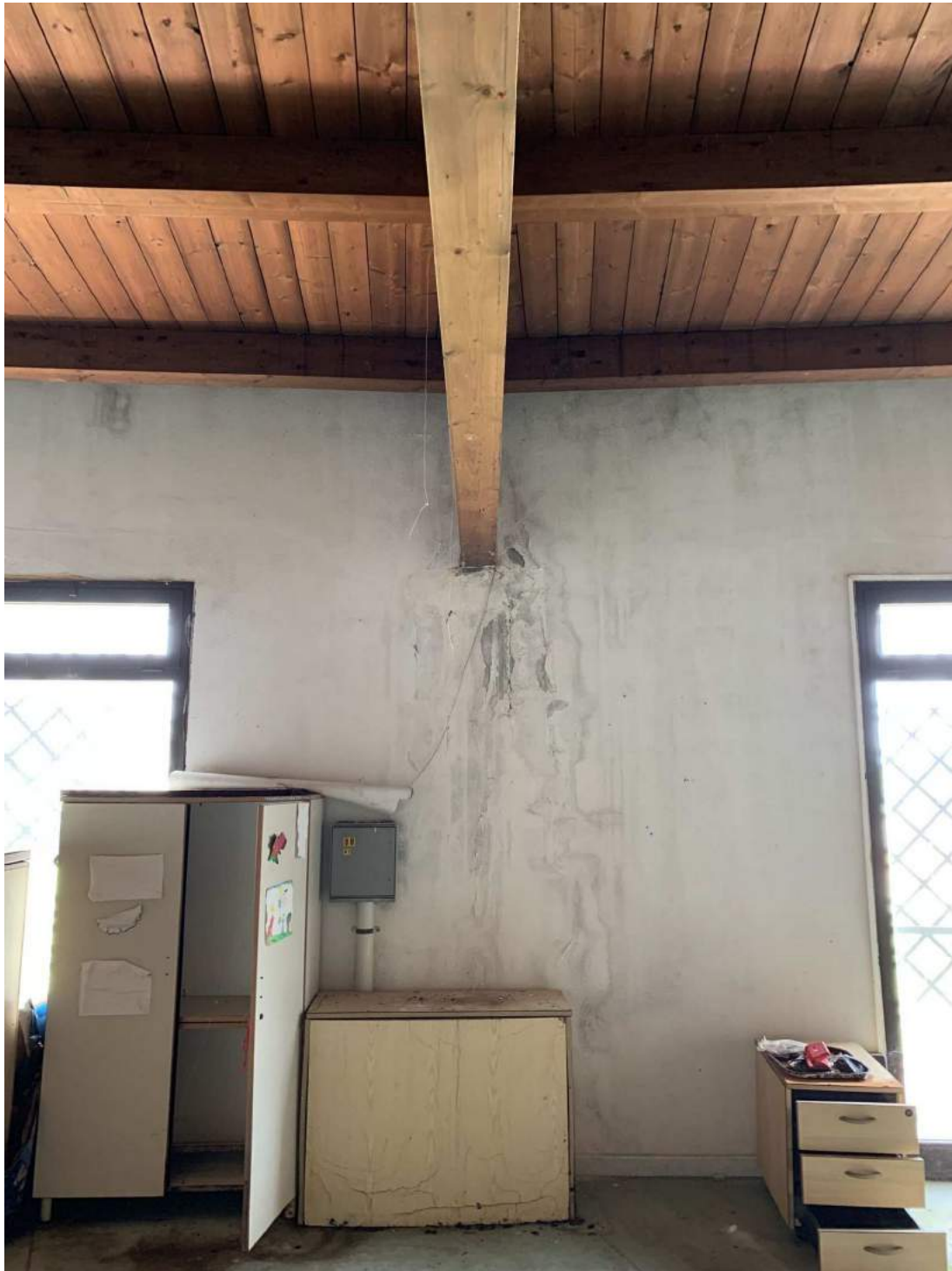
FOTO 20 - PIANO TERRA – UMIDITÀ DI RISALITA VISIBILE NELLE PARETI DELLA SALA POLIFUNZIONALE
