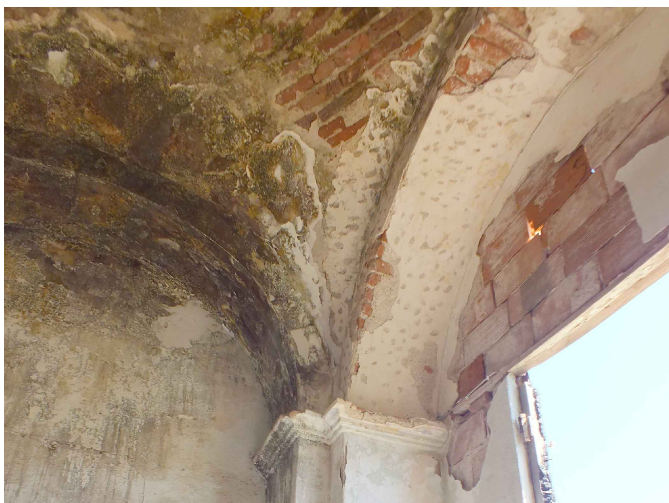
7_ Patina biologica, caduta di intonaco, degrado diffuso
