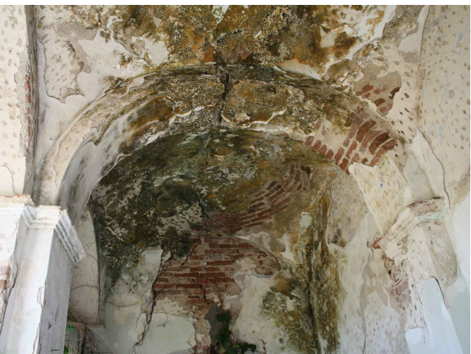
8_ Lesioni diffuse, infiltrazioni, patina biologica, caduta di intonaco
