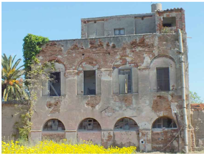
Mancanza di materiale, caduta di intonaco e in alcuni casi dei laterali del paramento murario nel prospetto sud-ovest
