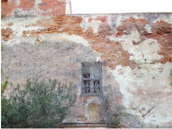
Mancanza di materiale, caduta di intonaco e in alcuni casi dei laterali del paramento murario nel prospetto principale
