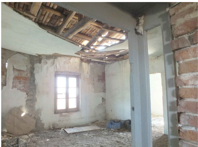
5_ Crollo di controsoffitto e copertura, degrado diffuso
