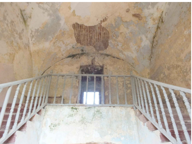
10_ Volta vano scala, alterazione cromatica, infiltrazioni, patina biologica, perdita materiali, lesioni
