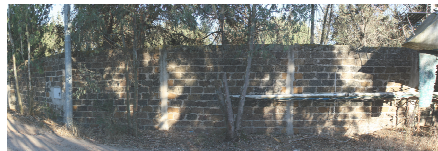
Traffo intermedia lato sud-ovest
