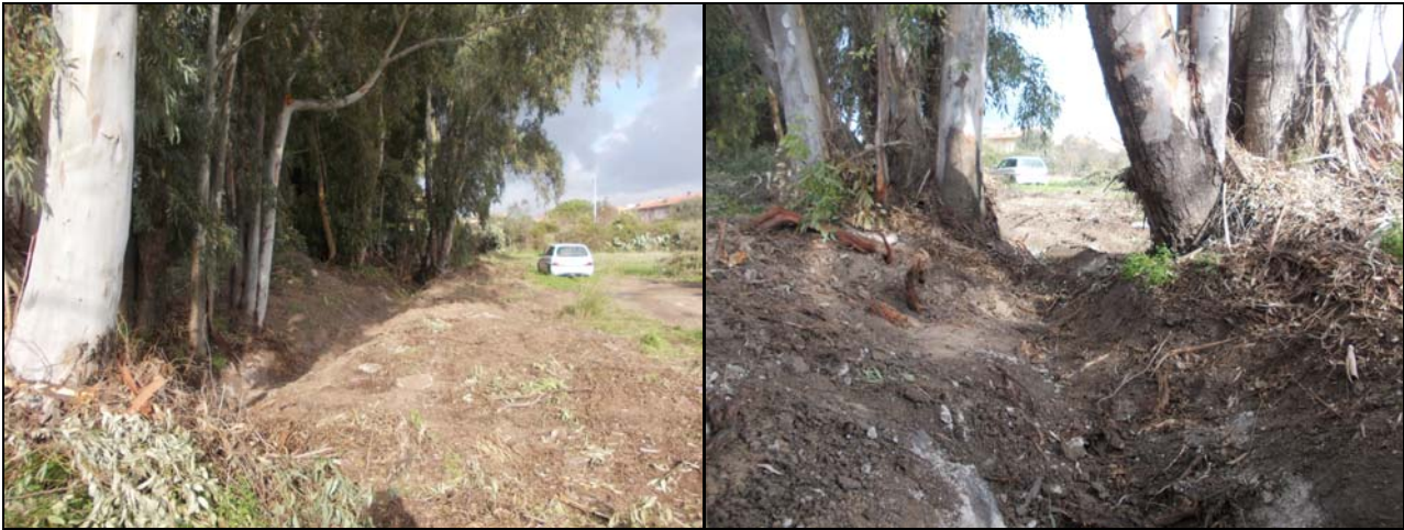
Figura 9: Canaletta est pesantemente danneggiata immediatamente a monte del rilevato ferroviario.
