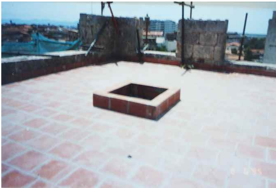
Copertura della torretta dalle foto dell'archivio della Soprintendenza di Cagliari Lavori relativi ai restauri del 1975.
