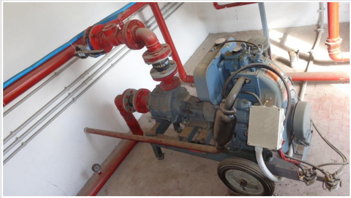
Elementi Impianto Antincendio in sasizione (moto-pompa, Attacchi UNI70)
