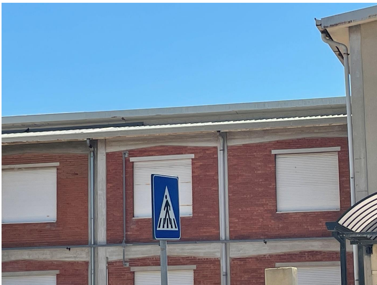
Figura 10: Parti ammalorate nelle mantovane, nelle grondaie e nei pluviali
