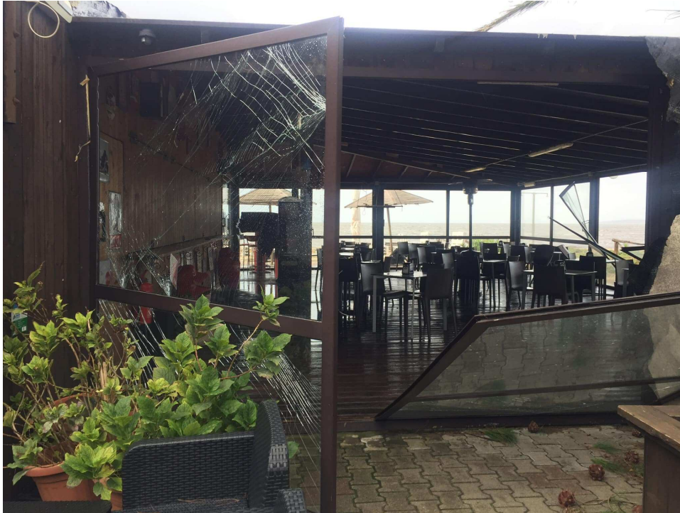
Foto 5 - Torregrande - Lungomare, chioschi danneggiati
