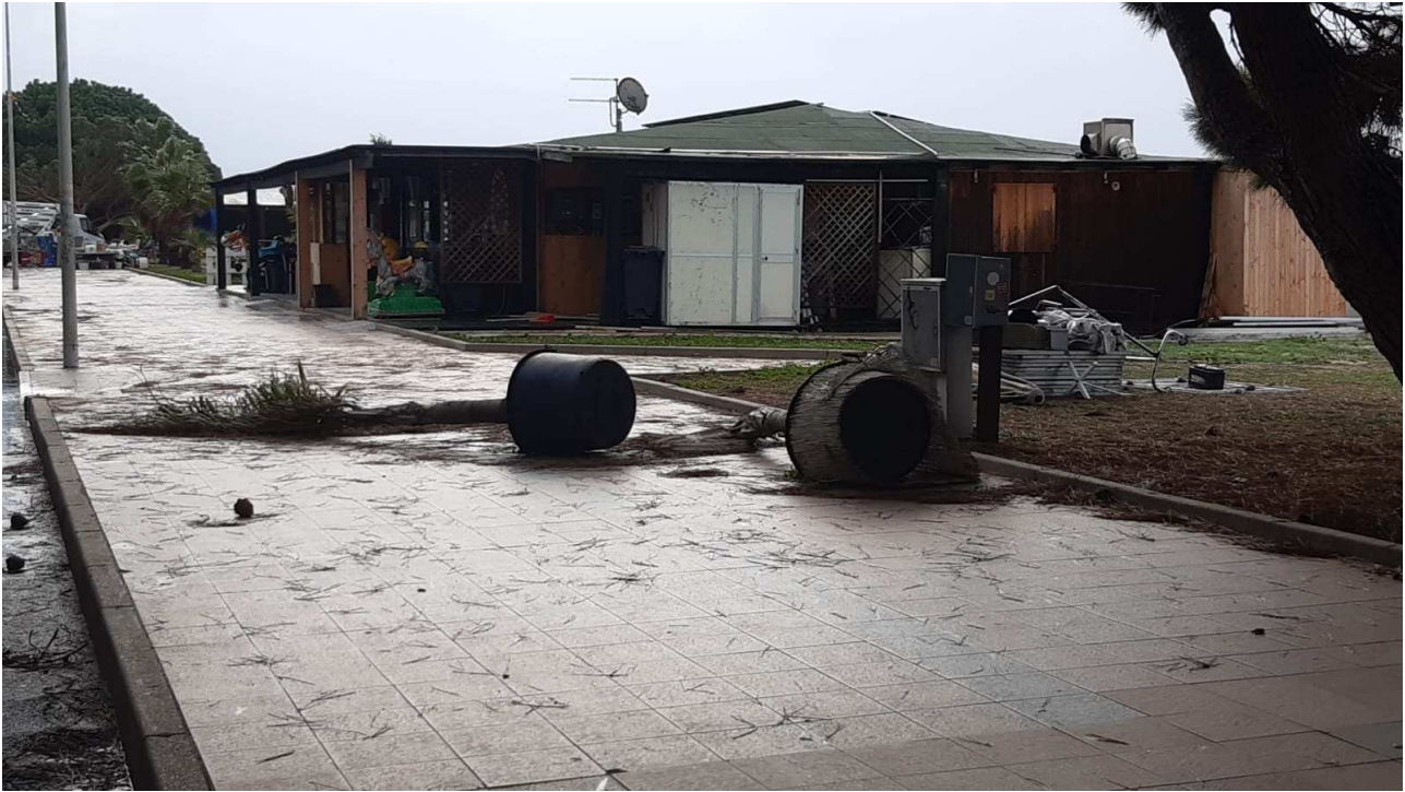
Foto 9 - Torregrande - Lungomare, chioschi danneggiati
