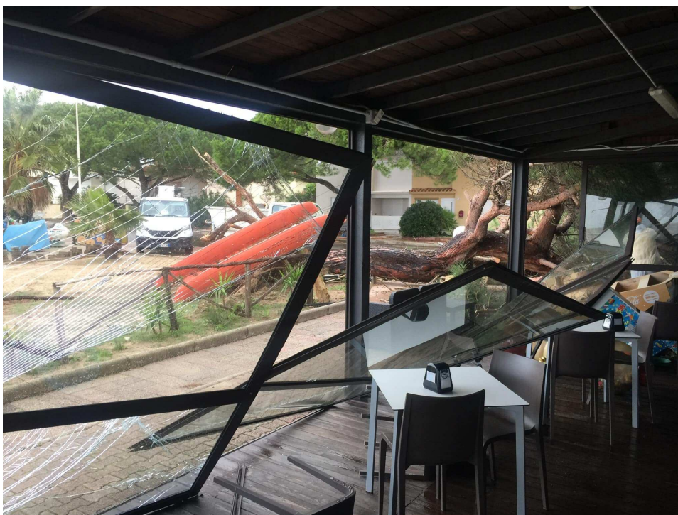
Foto 12 - Torregrande - Lungomare, Chiosco danneggiato dal vento
