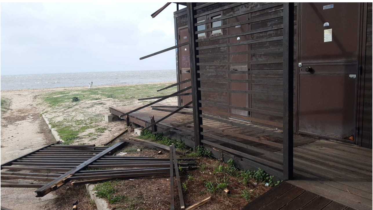
Foto 10 - Torregrande - Lungomare, servizi alla balneazione abbattuti dal vento
