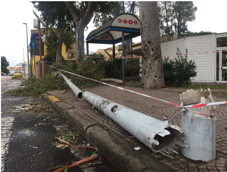
Foto 8 - Torregrande - Via Millelire, pali di illuminazione abbattuti dal vento
