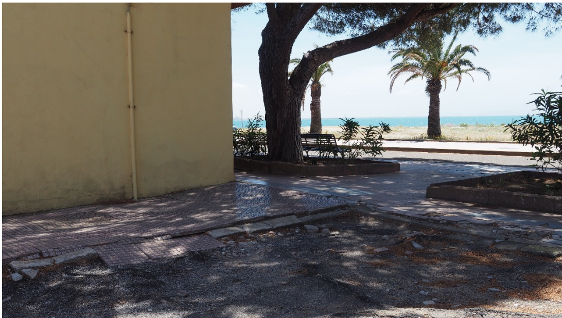
Figura 2: appare evidente nella foto il sollevamento della pavimentazione causato dalle radici
