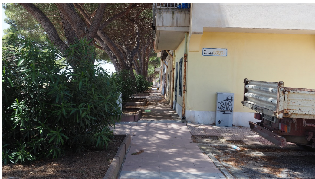
Figura 1: i pini cresciuti a ridosso degli edifici di abitazione. Sono evidenti i danneggiamenti causati dalle radici alle pavimentazioni.
