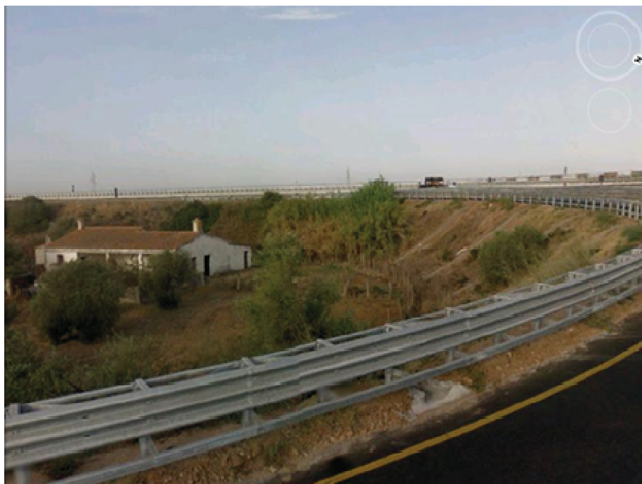
Foto n° 3.1 – Area di svincolo Oristano-Silì fianco rampa / strada A (ammorsamento scarpata, realizzazione rilevato, allungamento tubolare \phi 1000 )
