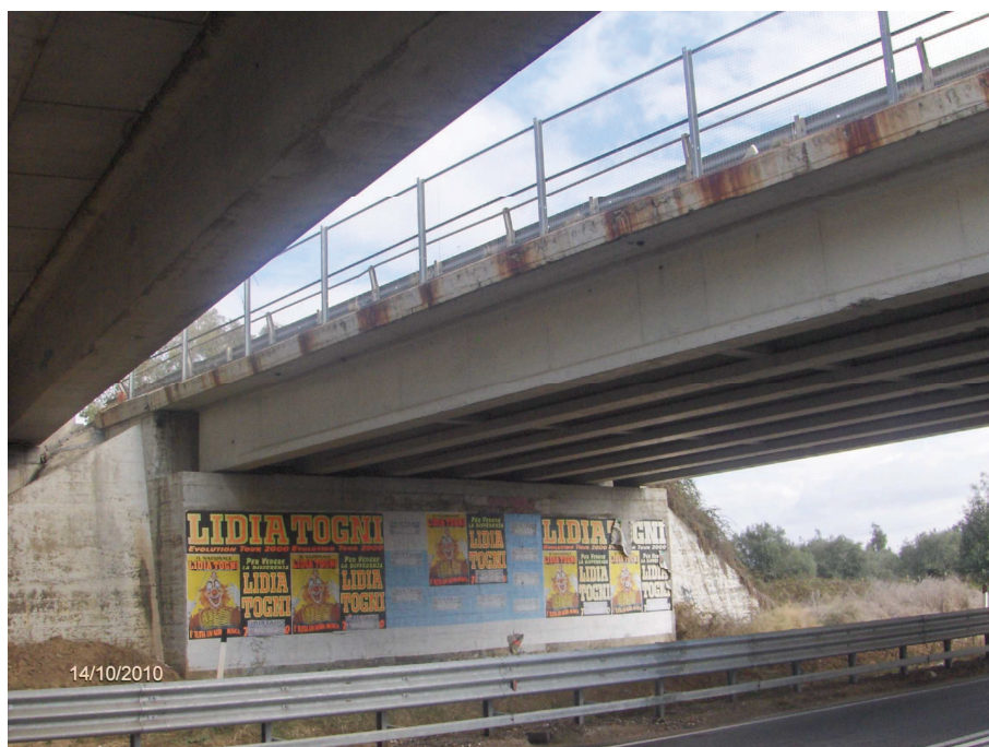
Foto n° 9.2 – Cavalcavia/ Cavalcaferrovia esistente (lato Oristano). Spalla Nord, cordolo e intradosso impalcato, superficie da risanare previa asportazione corticale e passivazione ferri, smontaggio rete parasassi e barriera bordo ponte (Int.1)
