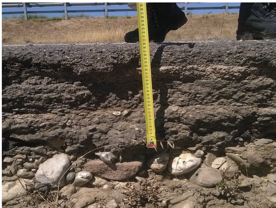
Foto n° 6.3 – Reliquato ex S.S. 131 (Zona 3) (fresatura pavimentazione stradale , posa in opera terreno vegetale e piantumazione)
