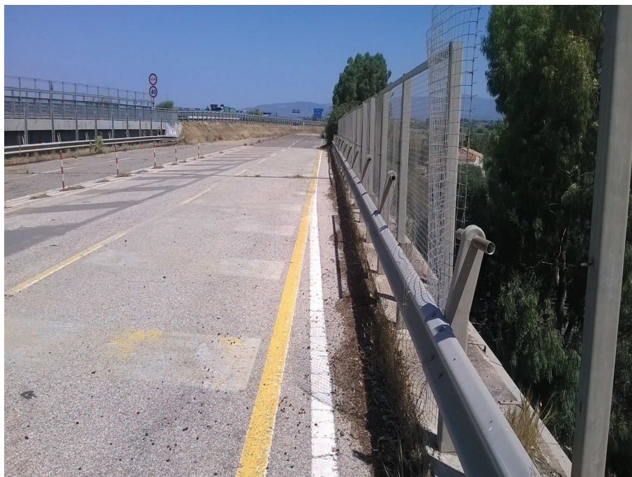
Foto n° 11.1 – Cavalcavia reliquato ex SS 131 (smontaggio barriera bordo ponte, taglio paletti non recuperabili, smontaggio rete parasassi e paletti, cancellazione segnaletica e zebraura)
