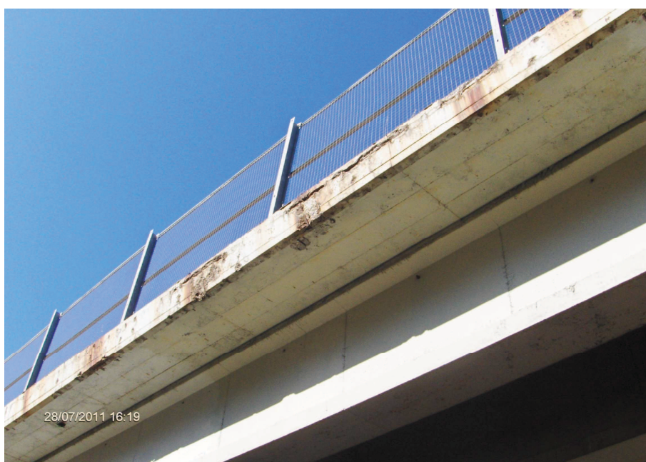
Foto n° 2.2 – Cavalcavia/ Cavalcaferrovia esistente (lato Oristano). Risanamento cordolo e intradosso impalcato previa asportazione corticale superficie.
