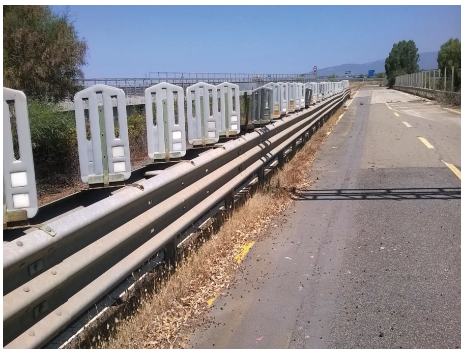
Foto n° 12.1 – Cavalcavia reliquato ex SS 131 (smontaggio barriera bordo ponte, taglio paletti non recuperabili, smontaggio rete parasassi e paletti, cancellazione zebraura e segnaletica, smontaggio/montaggio barriera centrale, sfalcio erba, smontaggio frangiluce)
