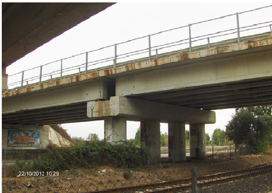
Foto n° 1.2 – Cavalcavia/ Cavalcaferrovia esistente (lato Oristano). Risanamento pulvino pila centrale, impalcato e cordolo soletta previa asportazione corticale superficie.
