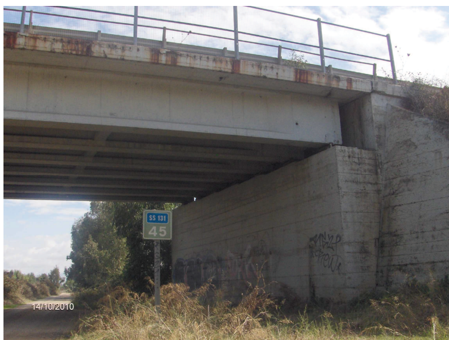
Foto n° 12.2 – Cavalcavia/ Cavalcaferrovia esistente (lato Oristano). Smontaggio rete parasassi, paletti e barriera bordo ponte (Int. 1). Risanamento cordolo impalcato previa asportazione corticale e passivazione ferri.
