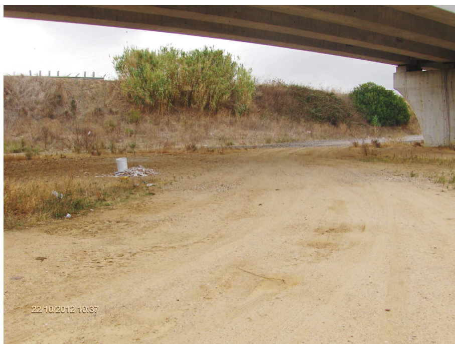
Foto n° 25.1 – Incrocio tra Strada B, ex reliquato SS 131 e Strada C (bonifica, fondazione in misto stabilizzato, cunette, scavo reliquato Zona 2)
