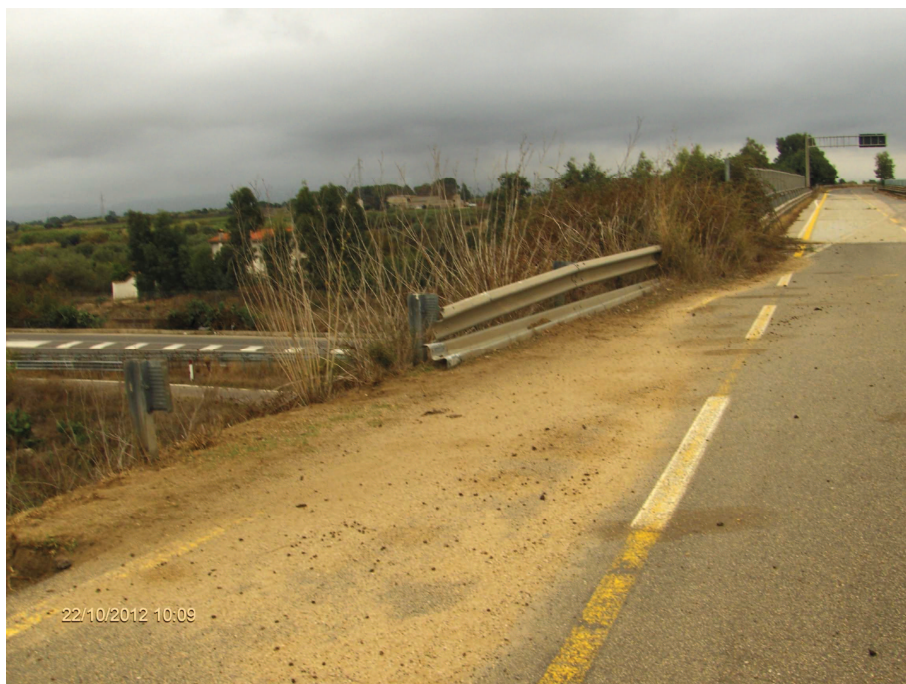
Foto n° 5.1 – Attacco Rampa Strada A con cavalcavia e reliquato ex SS 131 (smontaggio barriera esistente)
