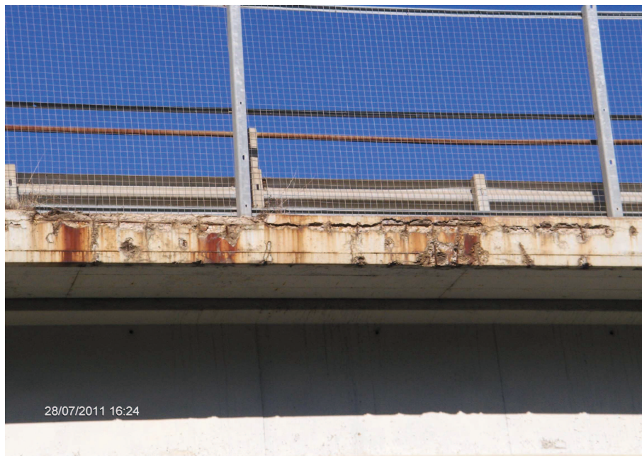
Foto n° 5.2 – Cavalcavia/ Cavalcaferrovia esistente (lato Oristano). Smontaggio rete parasassi , paletti e barriera bordo ponte, risanamento cordolo e intradosso impalcato, previa asportazione corticale e passivazione dei ferri (Int. 1)
