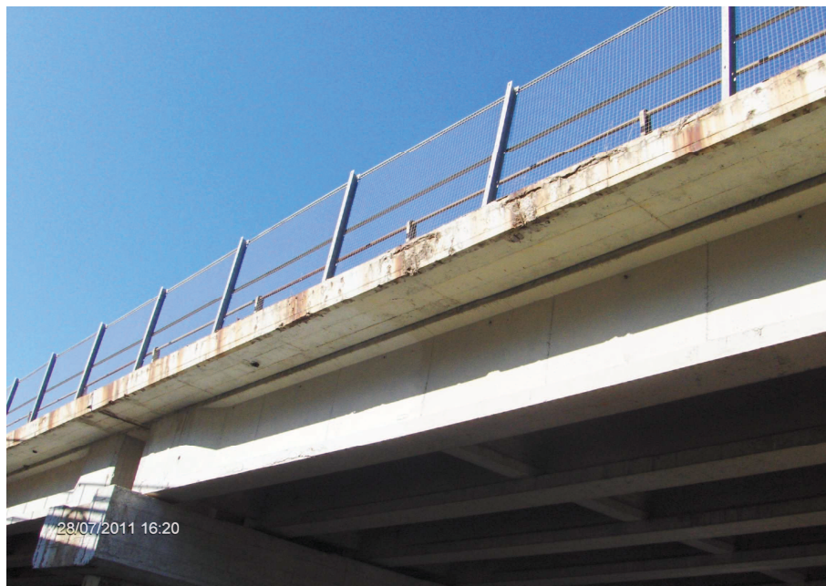
Foto n° 3.2 – Cavalcavia/ Cavalcaferrovia esistente (lato Oristano). Risanamento cordolo e intradosso impalcato, pulvino pila centrale, superficie da risanare previa asportazione corticale e passivazione ferri.
