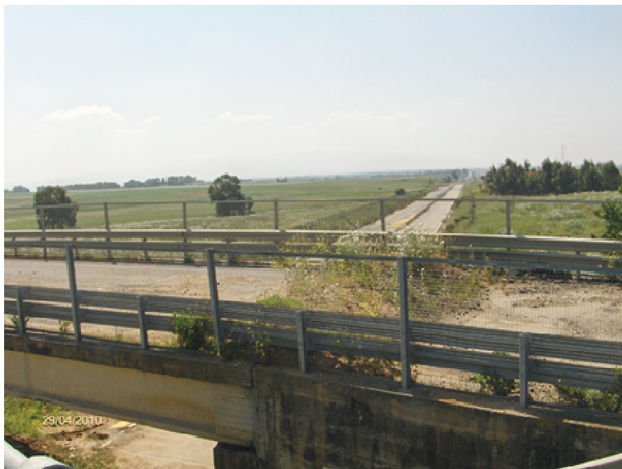
Foto n° 7.4 – Reliquato ex S.S. 131 "Oristano Nord" (posa recinzione metallica per chiusura cavalcavia dismesso)
