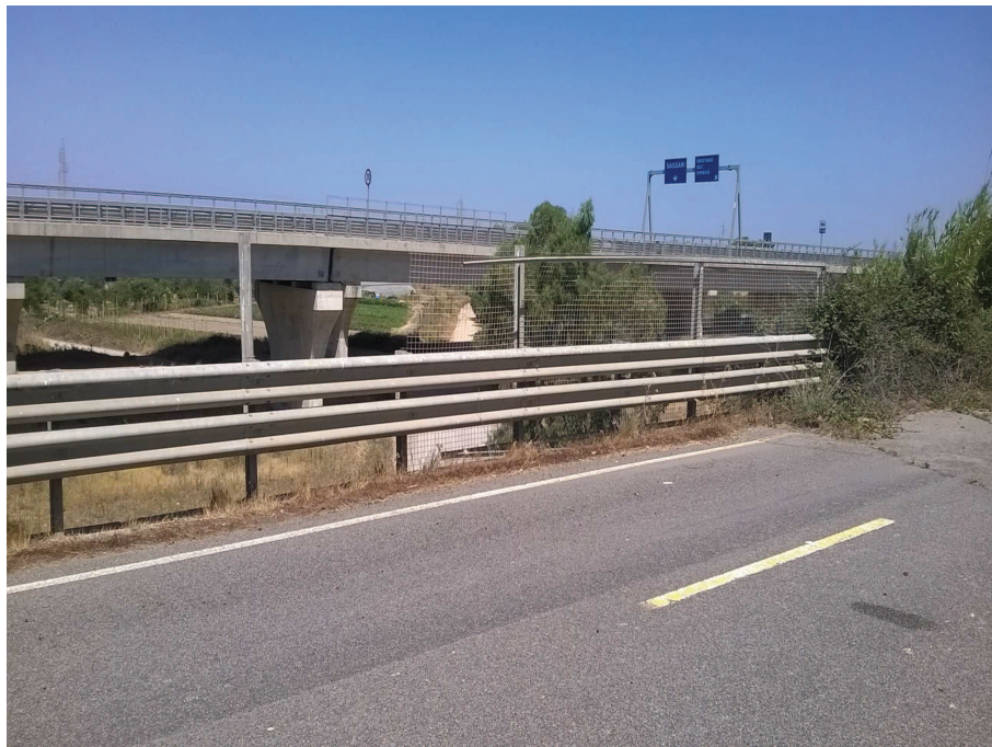
Foto n° 17.1 – Reliquato ex SS 131 pressi sottopasso (smontaggio barriera bordo laterale, smontaggio rete parasassi e paletti, fresatura pavimentazione lato sx (int.3))
