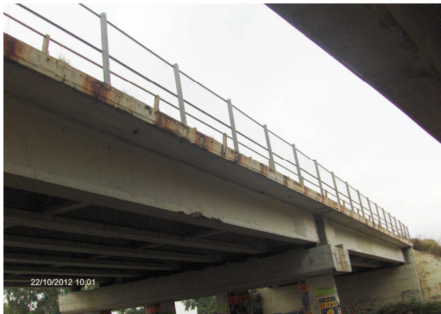
Foto n° 7.2 – Cavalcavia/ Cavalcaferrovia esistente (lato Oristano) Smontaggio rete parasassi , paletti e barriera bordo ponte, risanamento cordolo e intradosso impalcato, previa asportazione corticale e passivazione dei ferri (Int. 1)
