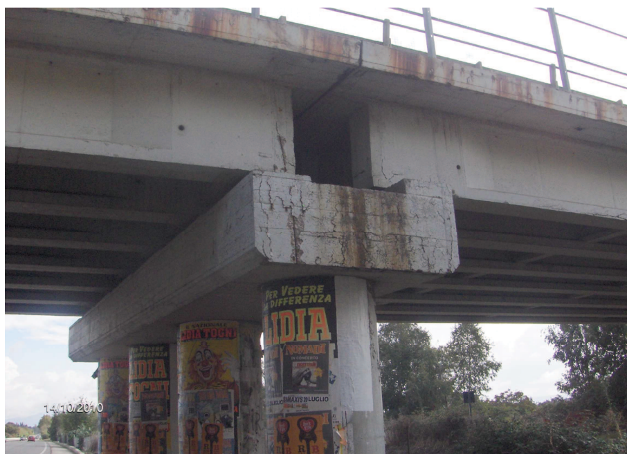
Foto n° 10.2 – Cavalcavia/ Cavalcaferrovia esistente (lato Oristano). Cordolo e intradosso impalcato, pulvino pila centrale, superficie da risanare previa asportazione corticale e passivazione ferri, smontaggio rete parasassi, paletti e barriera bordo ponte (Int. 1)
