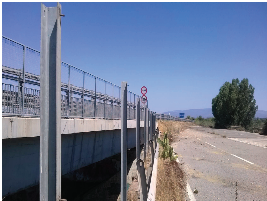
Foto n° 9.1 – Cavalcavia reliquato ex SS 131 (smontaggio barriera bordo ponte, taglio paletti non recuperabili, smontaggio rete parasassi e paletti)
