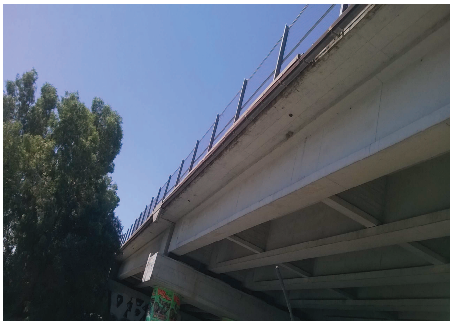
Foto n° 17.2 – Cavalcavia/ Cavalcaferrovia esistente (lato Simaxis). Smontaggio canaletta metallica, Smontaggio canaletta metallica, rete parasassi, paletti e barriera bordo ponte (Int.1). Risanamento intradosso impalcato previa asportazione corticale e passivazione ferri.
