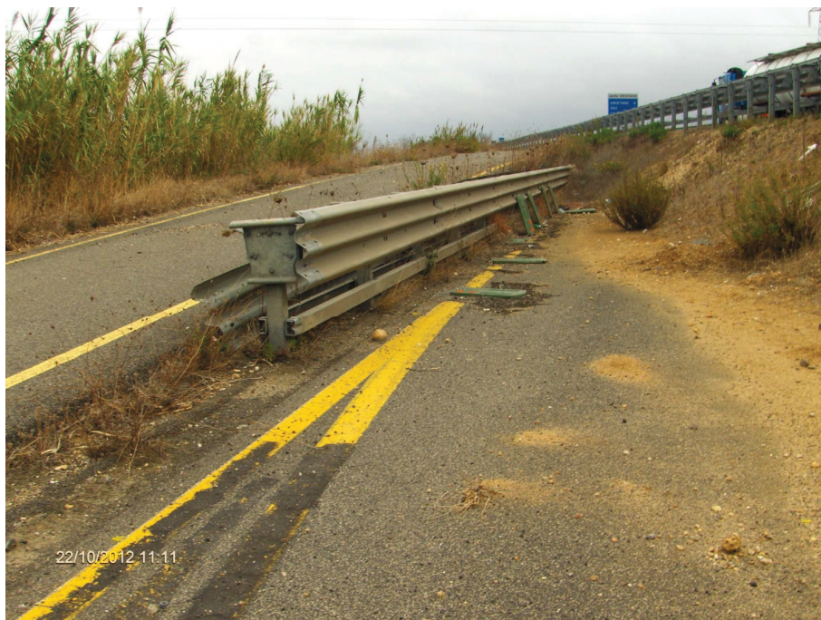
Foto n° 5.3 – Reliquato ex S.S. 131 (Zona 1) (fresatura pavimentazione stradale, posa in opera terreno vegetale e piantumazione, rimozione barriere (Int.1))
