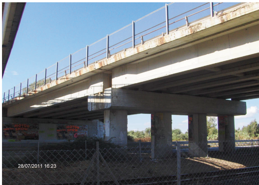
Foto n° 4.2 – Cavalcavia/ Cavalcaferrovia esistente (lato Oristano). Risanamento cordolo e intradosso impalcato, pulvino pila centrale, superficie da risanare previa asportazione corticale e passivazione ferri.
