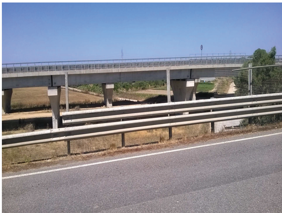
Foto n° 10.3 – Reliquato ex S.S. 131 (Zona 3) ( fresatura pavimentazione stradale, posa di terra vegetale e piantumazione, profilatura scarpata, rimozione barriere, paletti e rete antisasso)
