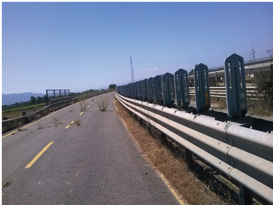
Foto n° 15.1 – Reliquato ex SS 131 pressi sottopasso (smontaggio barriera bordo laterale, smontaggio rete parasassi e paletti, cancellazione segnaletica, smontaggio/montaggio barriera centrale, sfalcio erba, smontaggio frangiluce, riparazione buche pavimentazione)
