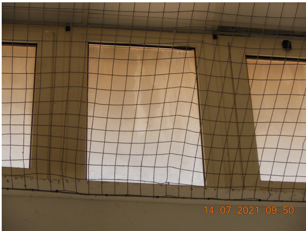
Stato degli infissi
