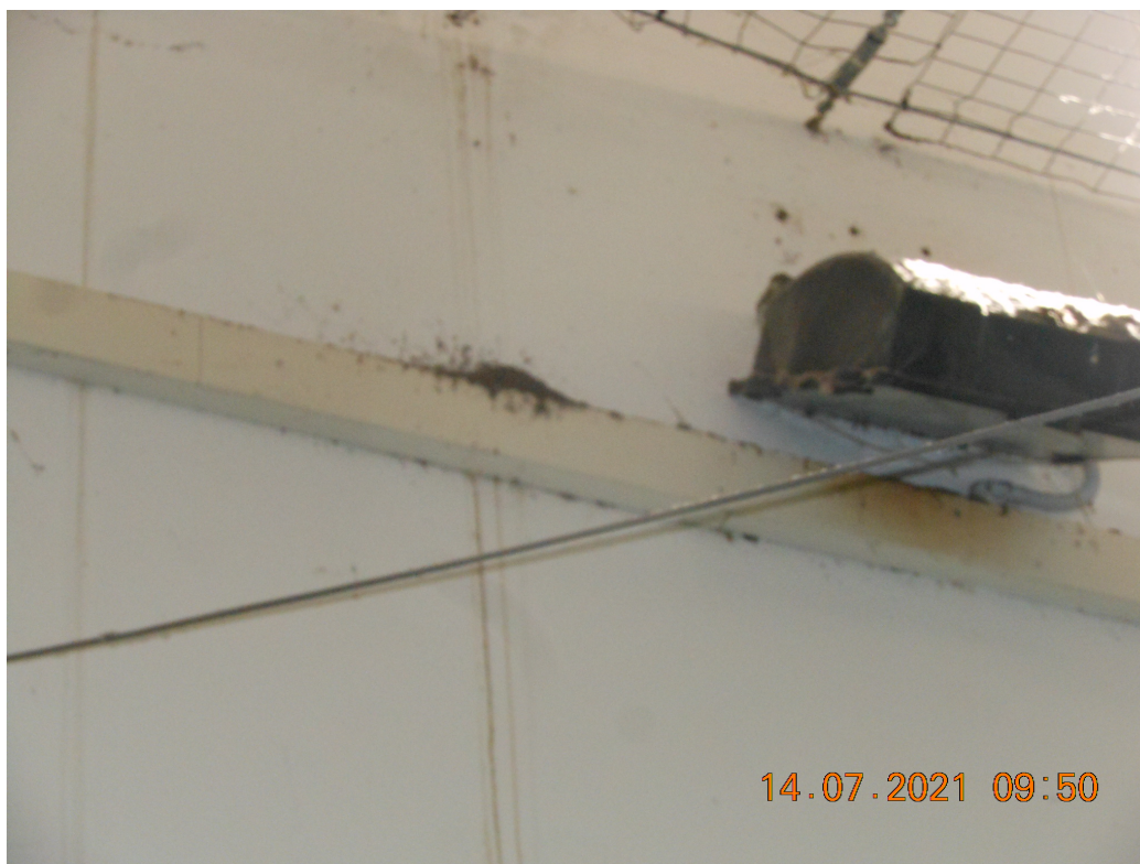
Guano di volatile causa della apertura nella copertura
