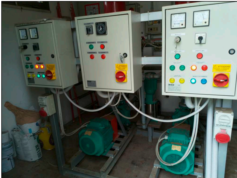
FOTO 4, IMPIANTO ANTINCENDIO ESISTENTE
