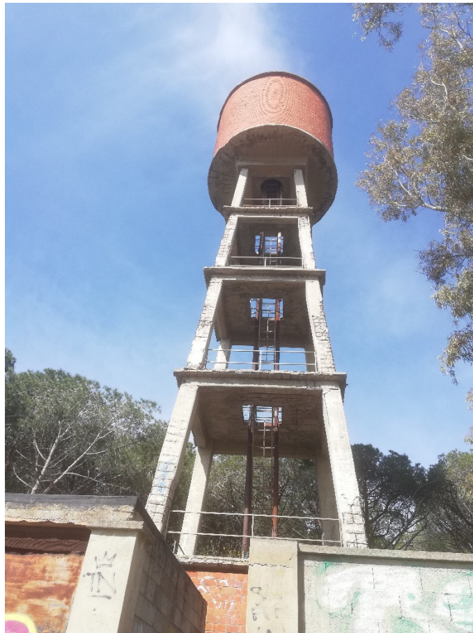
Figura 3 Serbatoio Pensile Torregrande
