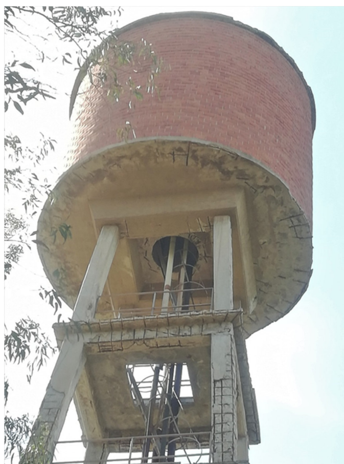
Figura 5 Particolare del Serbatoio
