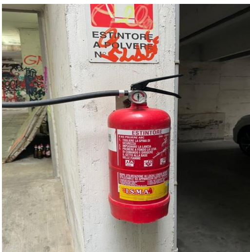
Foto n. 2 - Estintore scarico Via Verdi
