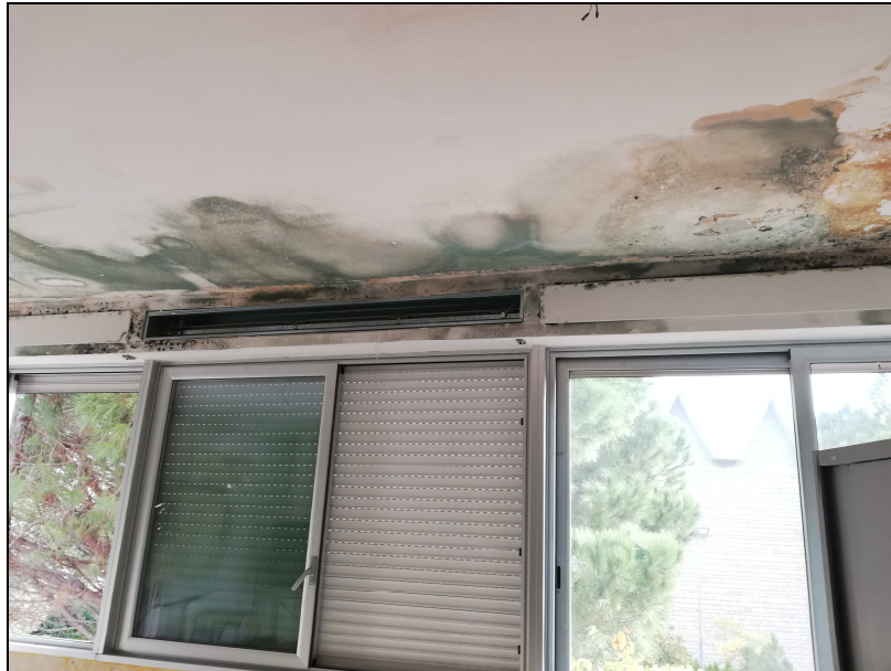
Figura 3 - Infiltrazioni d'acqua nelle aule
