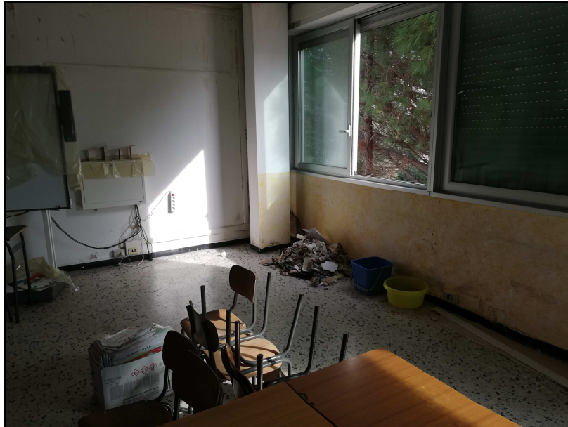
Figura 5 - Caduta controsoffitto in cartongesso
