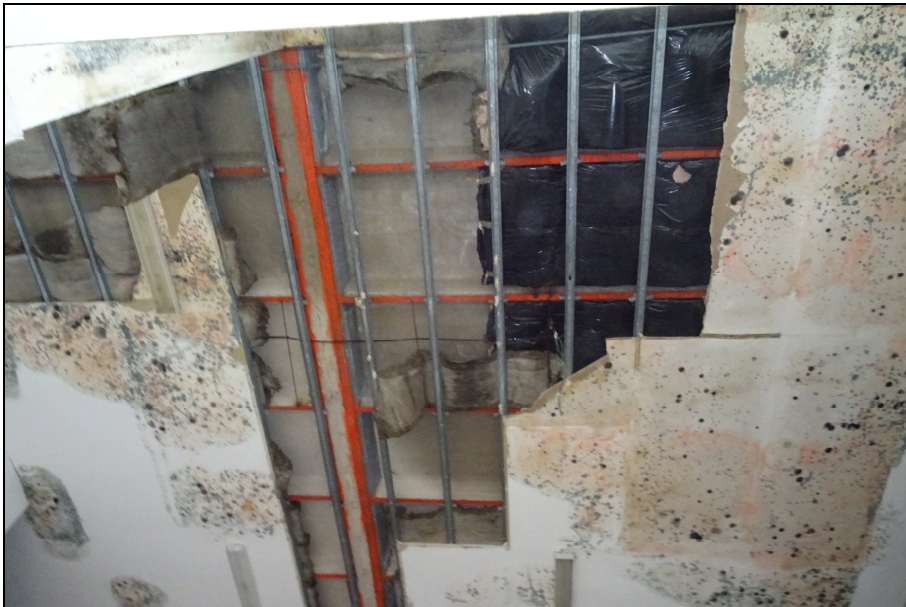
Figura 2 - Stato di degrado dei Cartongessi
