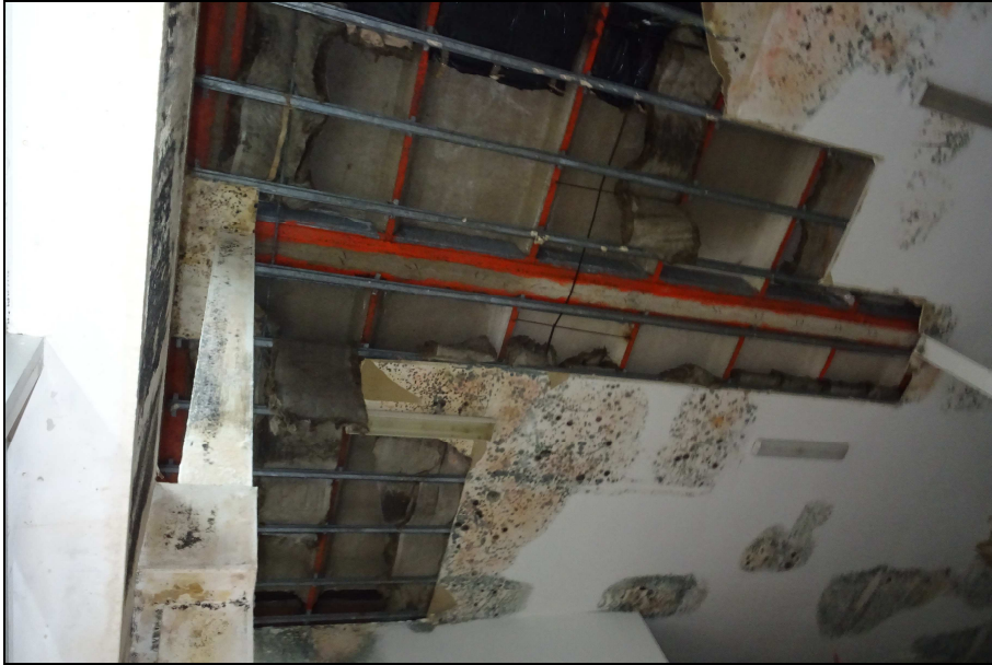
Figura 1 - Stato di degrado dei Cartongessi
