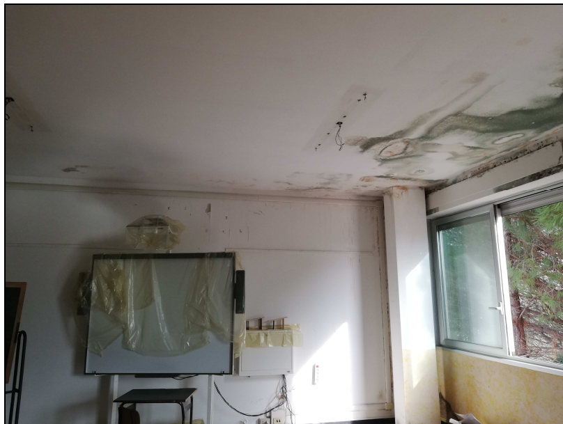
Figura 4 - Infiltrazioni d'acqua nelle aule
